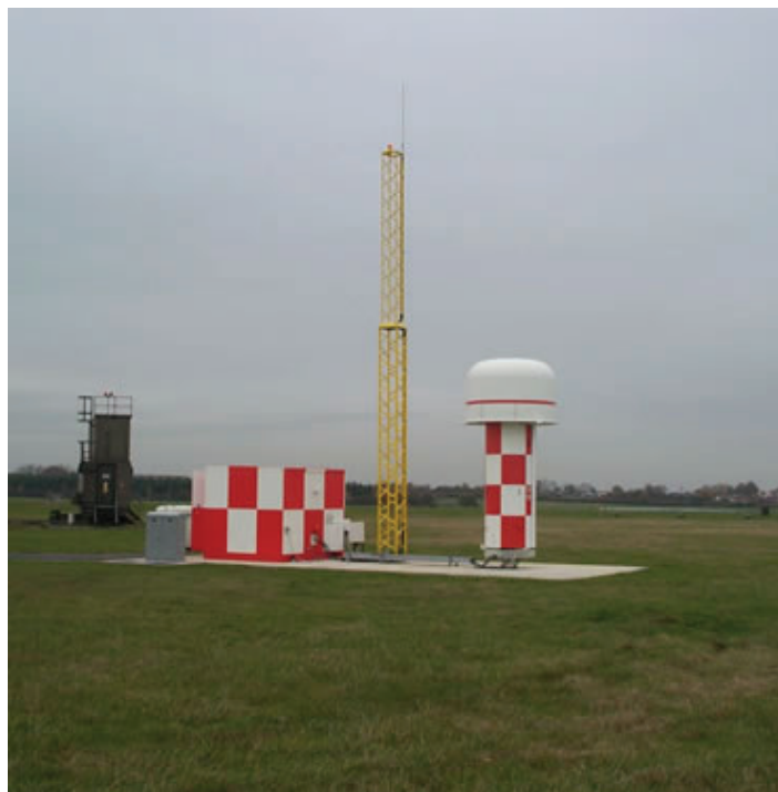
Figure 17.4: PAR installation at RAF Marham.
